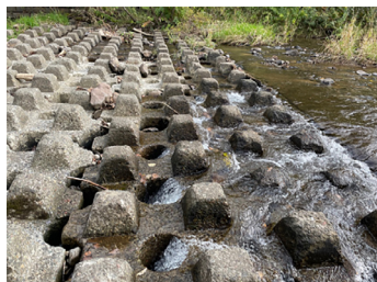
図5 遡上の障害となっている河川工作物（中～上流域）
